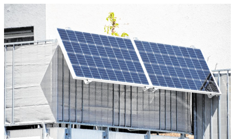
Selbst auf dem Balkon können kleine Solarstromanlagen Platz finden.
